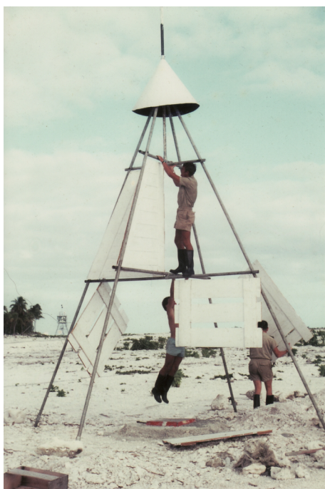
6 - fixation des panneaux blancs sur la pyramide, pour qu'elle ressorte bien dans le paysage photothèque Amhydro - N. Cloatre
